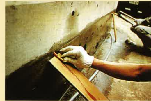
(1) 施工実験の状況: ガンで注入し、他方から溢れ出たら注入を止め、栓をする。
