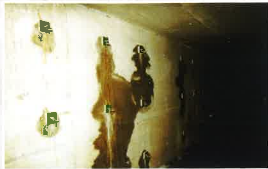
地下壁面セパ廻り漏水状況
